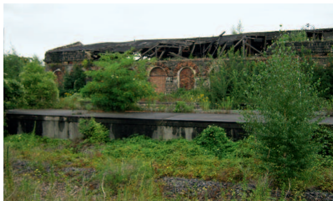
Ehemalige Bahnbrache in Dresden, auf der wiederholt gedealt wurde und illegale Partys gefeiert wurden. Die Stadt hat gegenüber dem Eigentümer die Sicherung mit Erfolg veranlasst.
